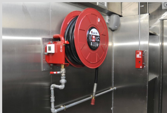
RIA - Trappe de désenfumage
